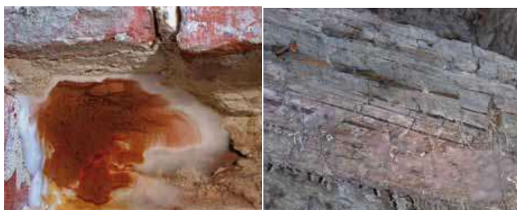
Grzyb domowy właściwy - Owocnik - Wygląd zaatakowanego drewna
